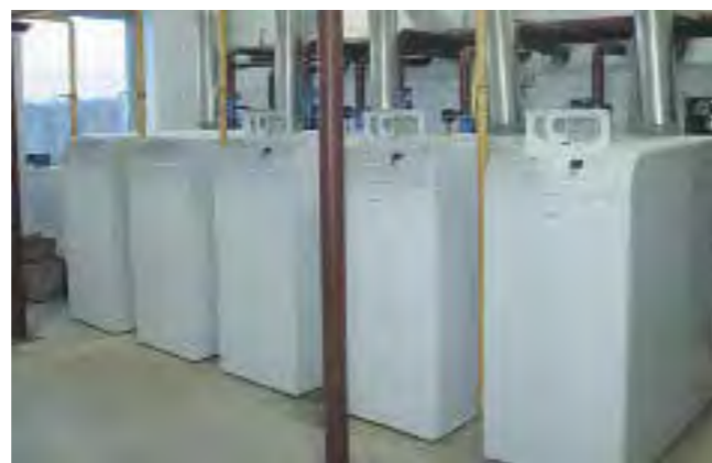
Кинотеатр, г. Йошка-Ола Общая мощность - 1,6 МВт
