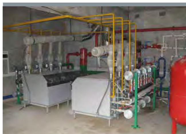
Спорткомплекс «Гладиатор», г. Нальчик POWER HT, общая мощность — 1,2 МВт
