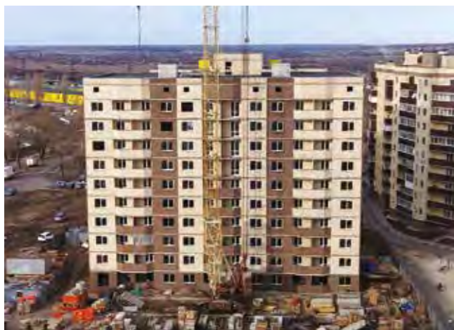
Жилой дом, г. Семилуки POWER HT, общая мощность — 560 кВт
