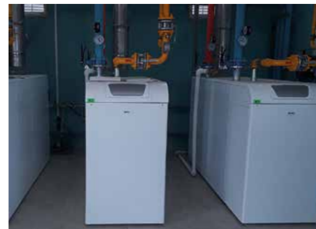
Жилой дом, г. Сочи POWER HT-A, общая мощность — 1,5 МВт
