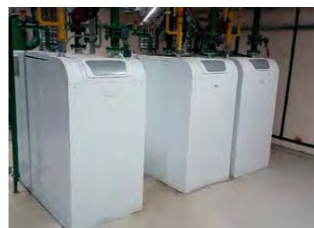
Офисный центр, г. Саратов POWER HT, общая мощность — 960 кВт
