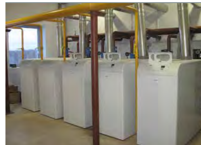
Кинотеатр, г. Йошкар-Ола POWER HT, общая мощность — 1,6 МВт
