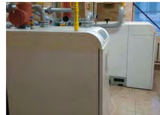
Гостиничный комплекс «Бережки-Холл», г. Егорьевск POWER HT-A, общая мощность — 820 кВт
