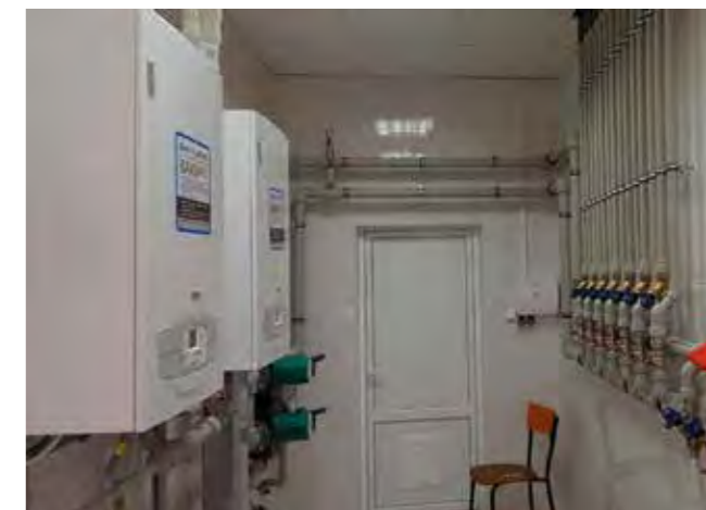
Ресторан McDonald's, г. Геленджик Duo-tec MP, общая мощность — 140 кВт
