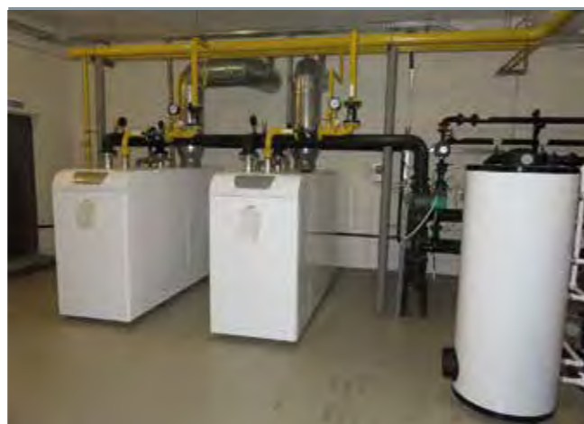
ТЦ «Крона Парк», г. Чебоксары POWER HT-A, общая мощность — 1 МВт
